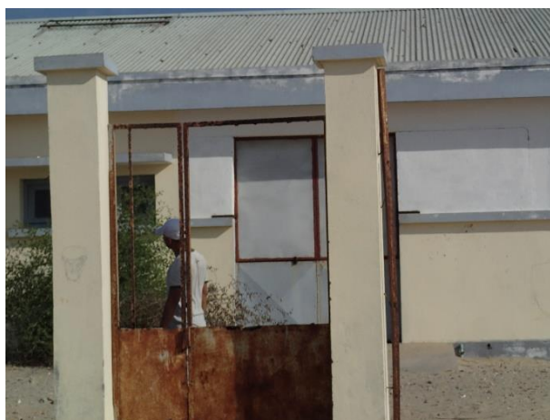
Rouillure très avancée du portail
