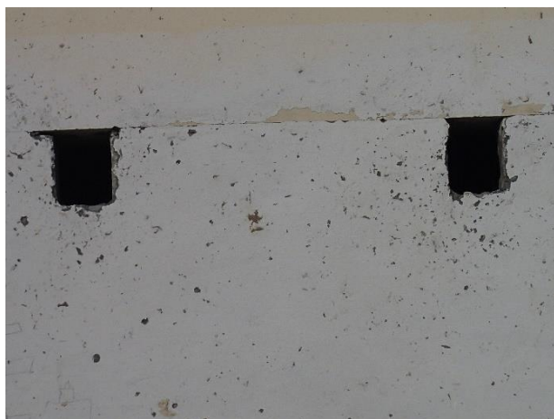
Trous d'aération de la salle de traitement des produits
