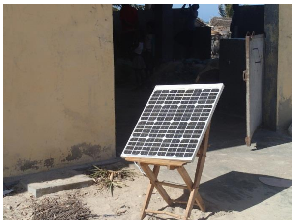
Nouveau panneau solaire
