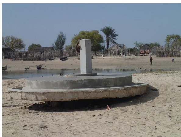
Erosion très avancée
