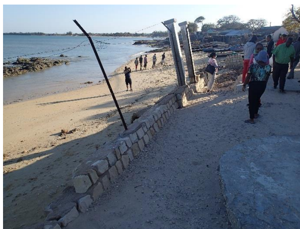
Clôture détruite + effondrement
