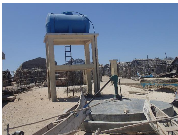
Pompe et réservoir d'eau
